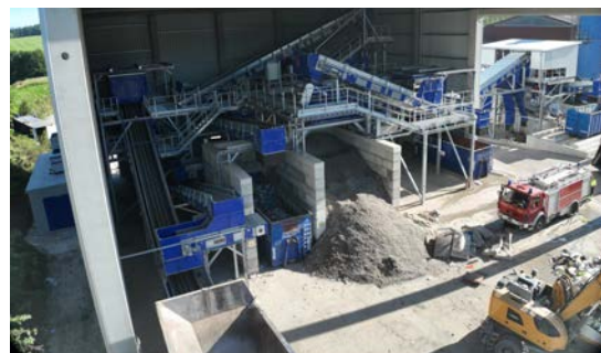
Gewerbeabfallaufbereitungsanlage auf dem Ellert
