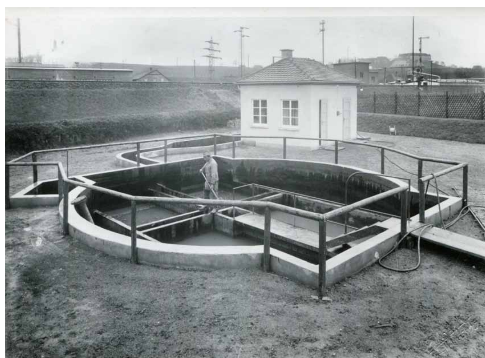
Ein Beispiel für eine der ersten Kläranlagen im Ostalbkreis: Ellwangen im Jahr 1957.
